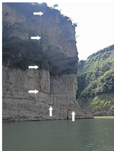
图 3 棺木岭危岩体的全景照片
