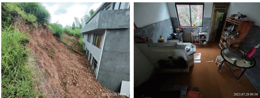
图 8 温州市平阳县顺溪镇下东村滑坡
