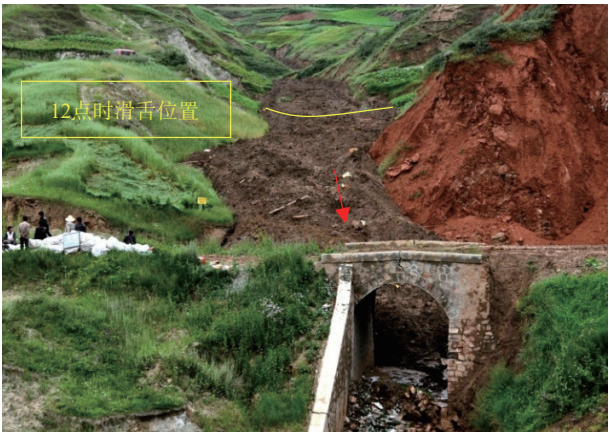
图 7 滑坡前舌及挤压变形的小桥
